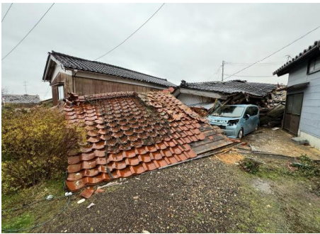
全壊したH宅
