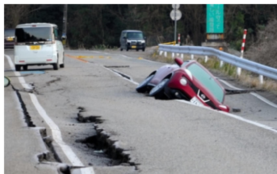
珠洲道路 陥没 段差 亀裂
