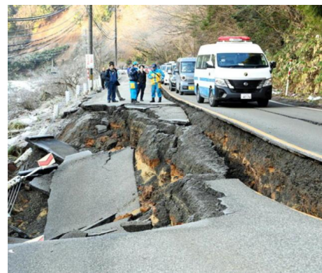
穴水 陥没 段差 亀裂
