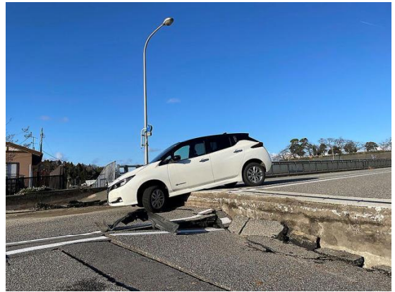
穴水 橋で 段差 亀裂
