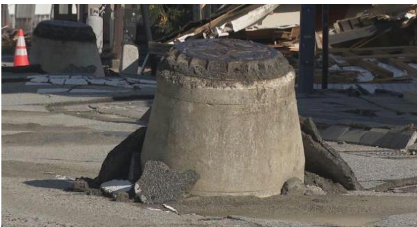
飛び出したマンホール
